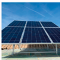
ENERGÍAS RENOVABLES, FOTOVOLTAICAS,
